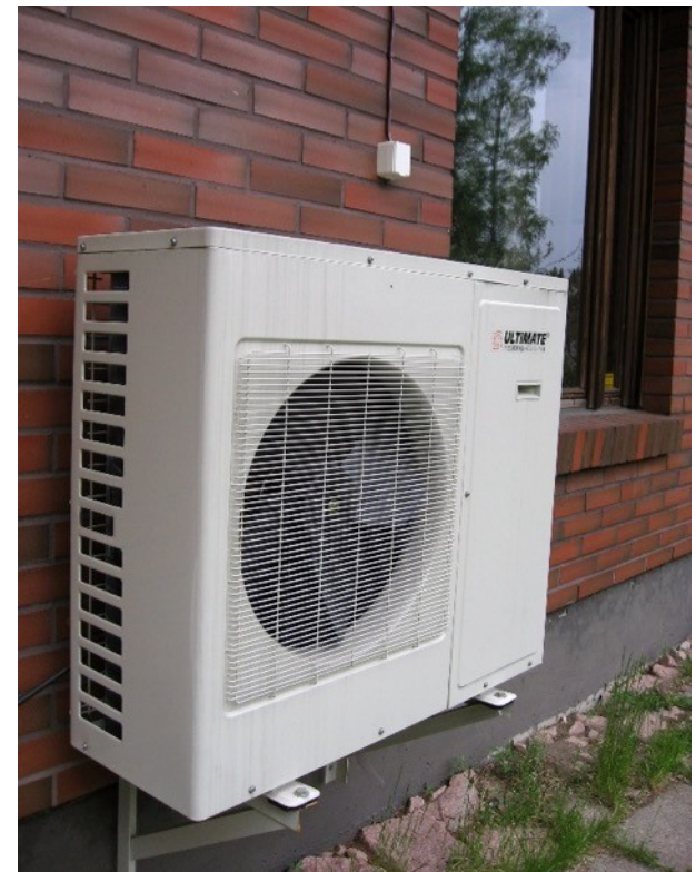
Außeneinheit einer Luft-Wasser-Wärmepumpe
