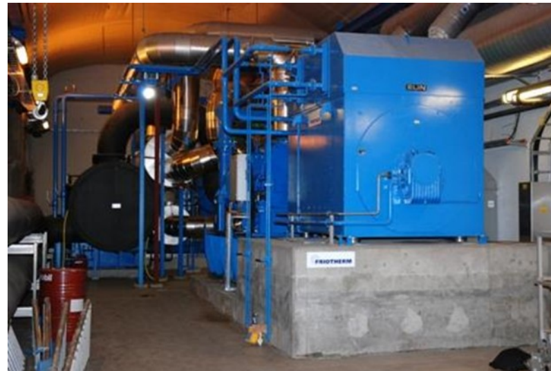
Abwasser-Wärmepumpe Oslo (27 MW)
